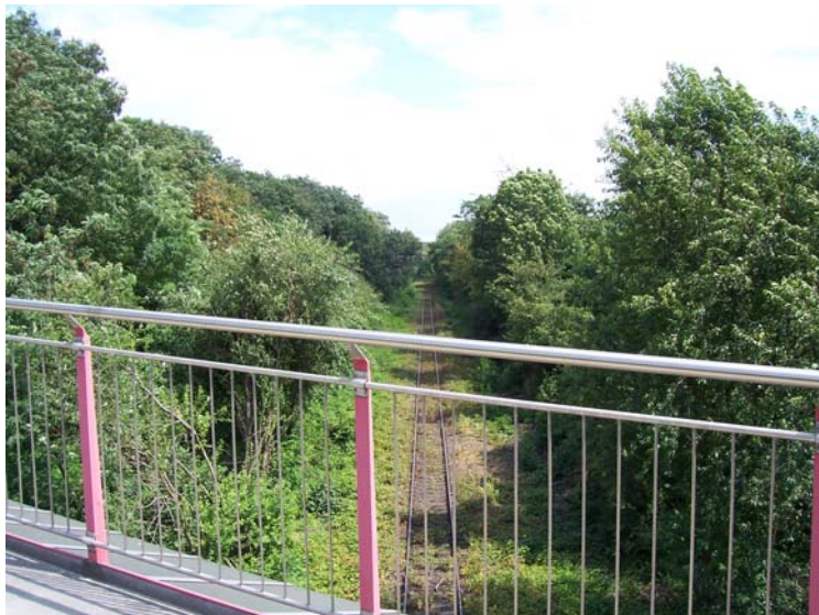
Beispiel für ein einfaches Brückengeländer (ErlebnisTrasse Erzbahn)
