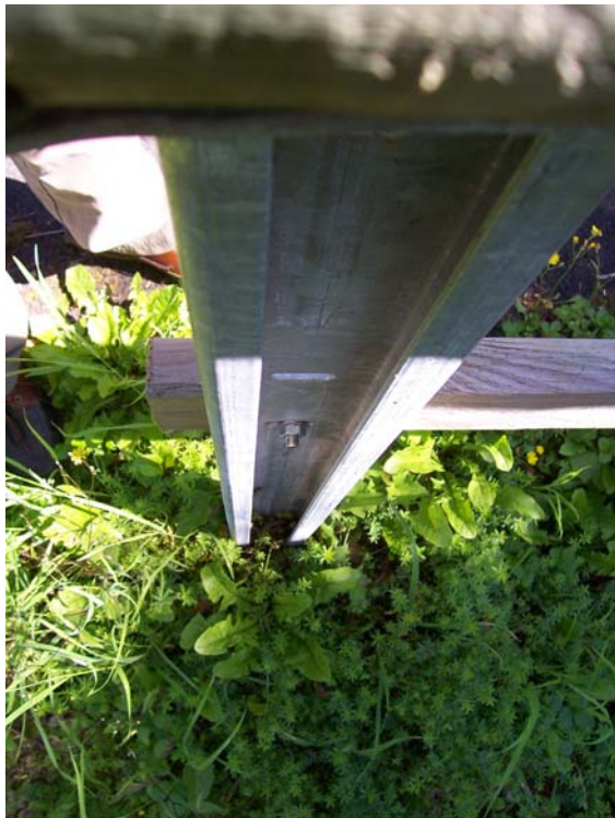
Detailansicht einer Verschraubung (Maare-Mosel-Radweg)
